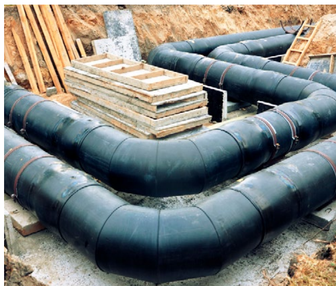
/ Un réseau de chaleur fonctionne grâce à un réseau de canalisations d'eau chaude.
